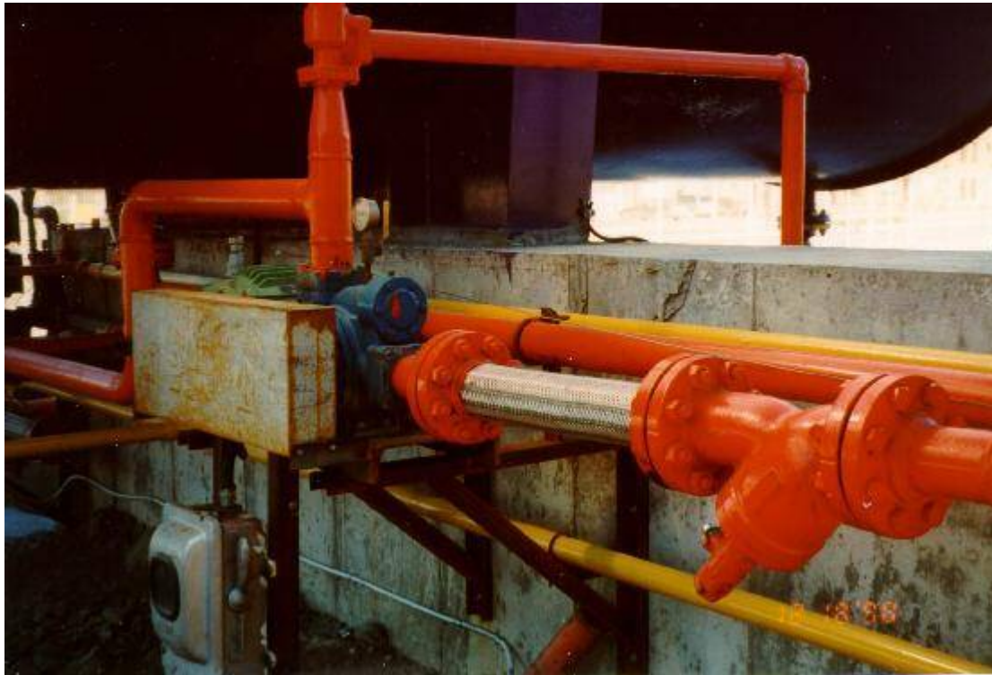
Figure 5 Tuyauterie sous le réservoir de propane
